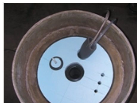
Saubere Isolierung bei Winterschacht, gegen Fallkälte garantiert Frostsicherheit.
